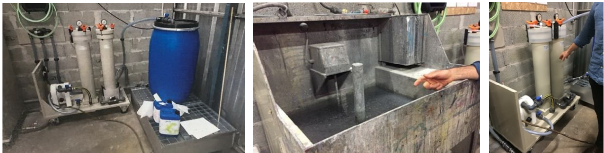
Photos 147, 148, 149 : système de traitement des produits de peinture vernis et autres substances avant de les adresser vers un centre de récupération des déchets spéciaux
